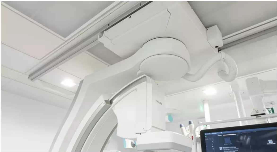
Plafond soufflant dans une salle d'intervention
